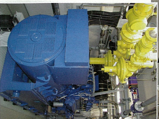
Ein 700-kW-BHKW erzeugt aus Biogas Strom und Wärme für Neuhof
